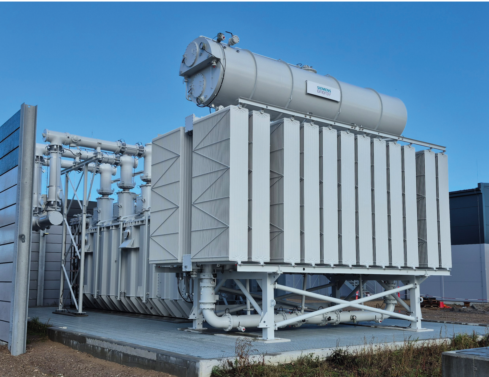
Siemens Power Transformer, Lemvig.
